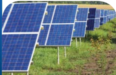
Sicherheit für Photovoltaik-Anlagen
